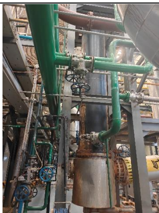
换热器（现有，换热面积 205m 2 ）
