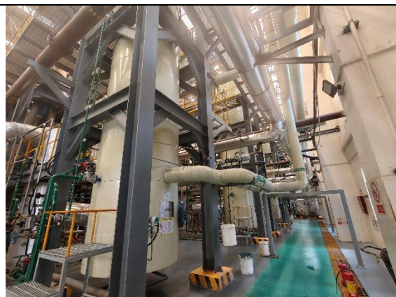
换热器（新增，换热面积 600m 2 ）
