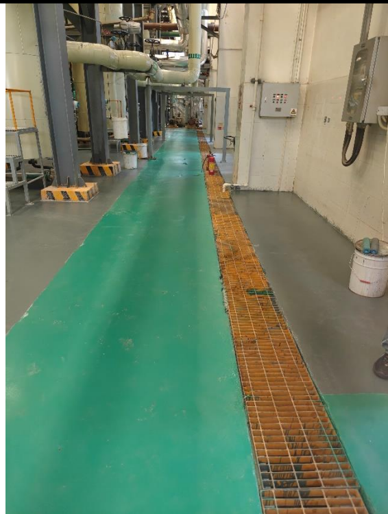
污泥干化车间收集沟
