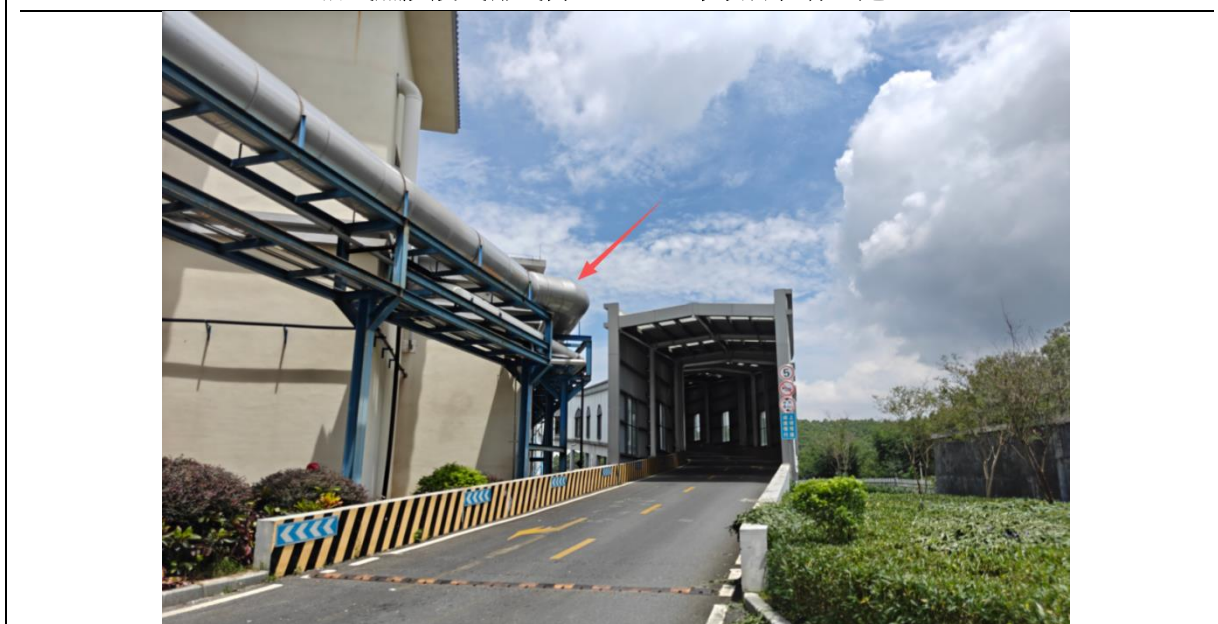
新建臭气收集管道（引入瀚蓝（开平）固废处理有限公司焚烧炉作为一次风）
