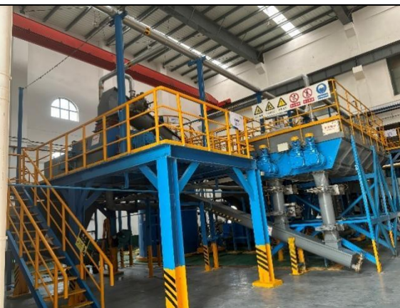
污泥干化车间内部
