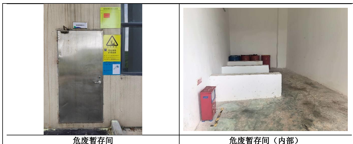
图 3.4-1 本项目现有已建固体废物暂存措施
