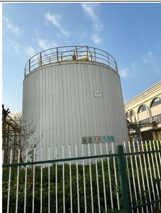
餐厨预处理系统-水解罐
