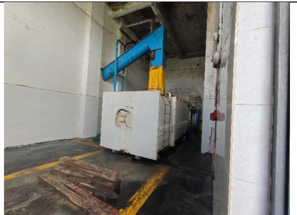
餐厨垃圾固渣仓
