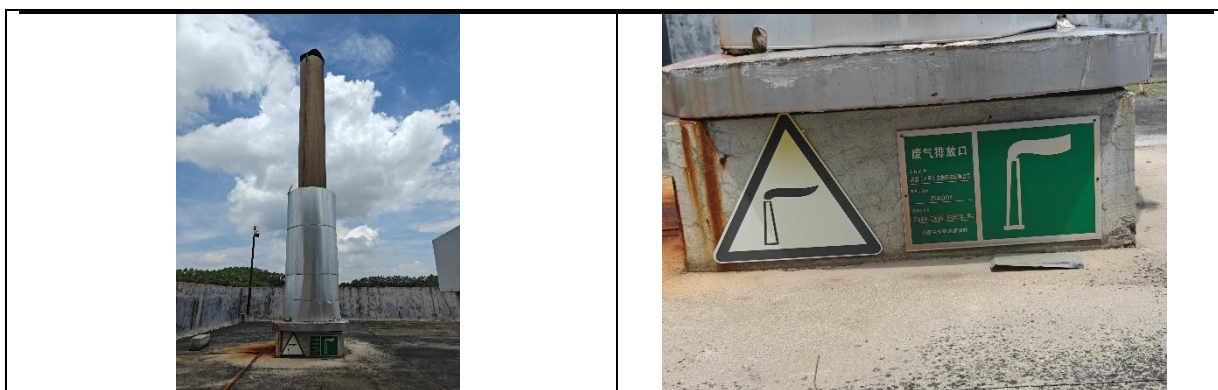
沼气燃烧废气排气筒 DA001（本项目现有已建）
