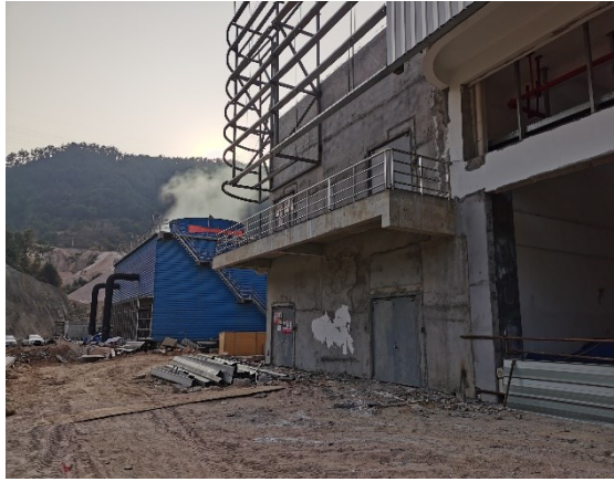
图片 7 升压站现状
