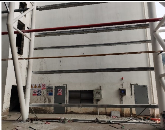
图片 9 升压站现状
