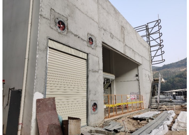
图片 8 升压站现状
