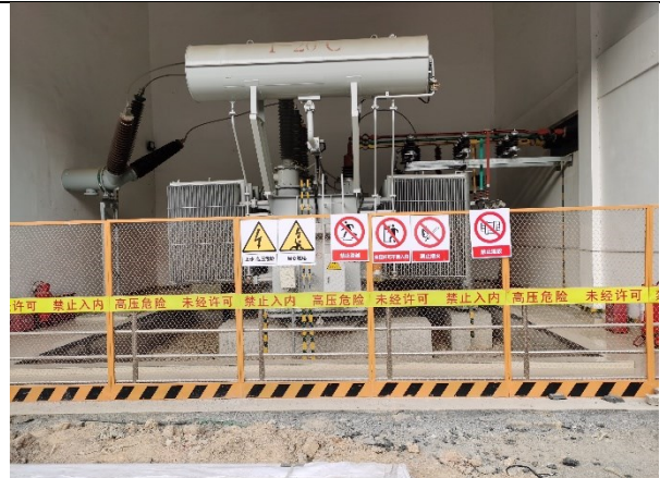
图片 6 升压站现状
