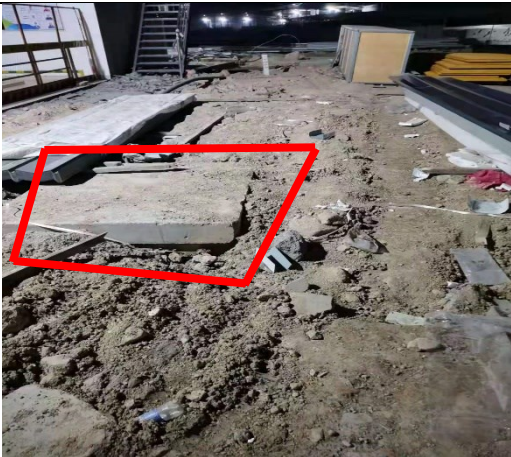
图片 11 事故油池
