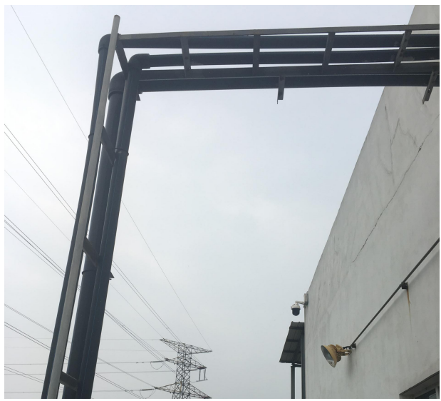
事故废水收集管道
