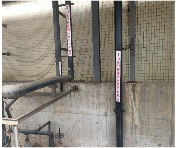
废水输送管道
