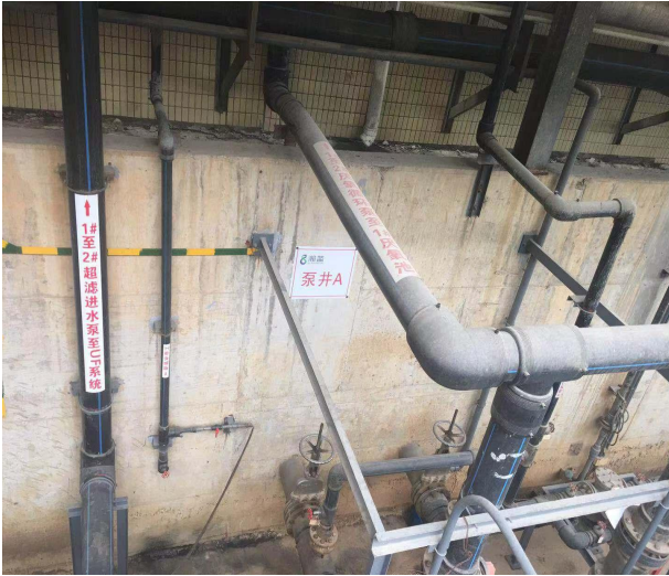
废水输送管道
