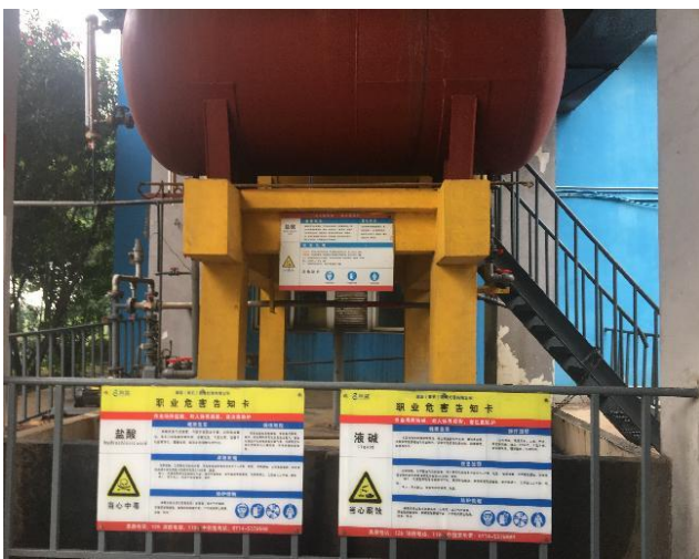
盐酸和液碱储罐区
