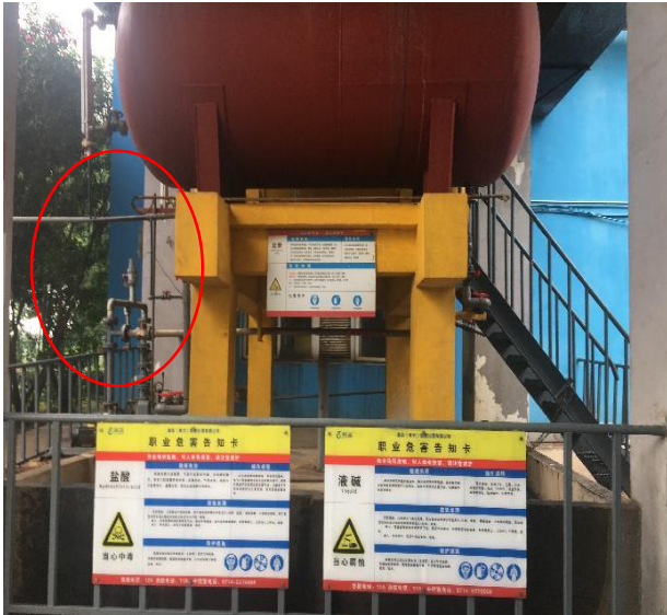
盐酸夜间输送管道
