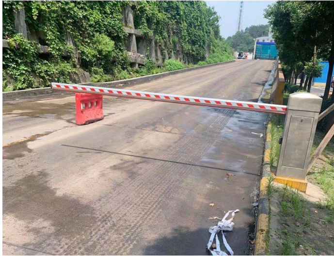
厂内栈桥渗滤液滴漏
